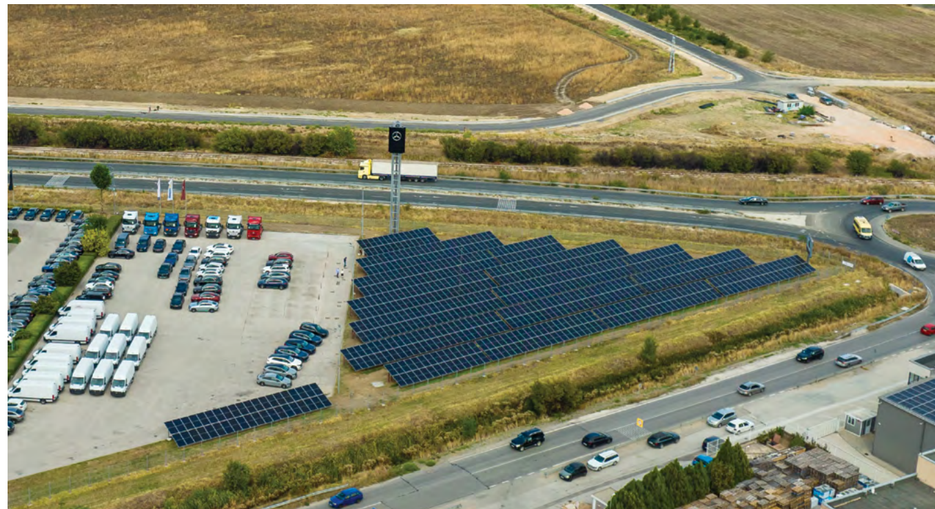
Пилотната фотоволтаична инсталация, изградена от EVN България за бизнес клиент, захранва със зелена енергия представителството на Силвър Стар в Пловдив.
